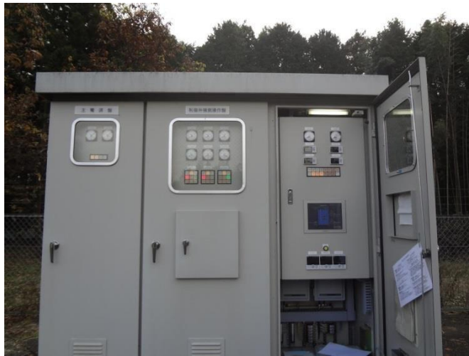
Ilustración 39 Dispositivo regulador de presión.
