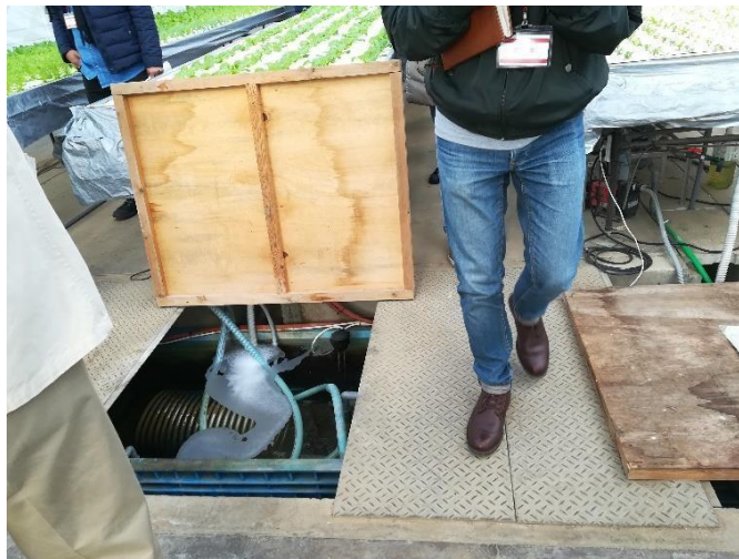
Figura 45 Tanque recolector de excesos de solución con resistencia para control de temperatura.
